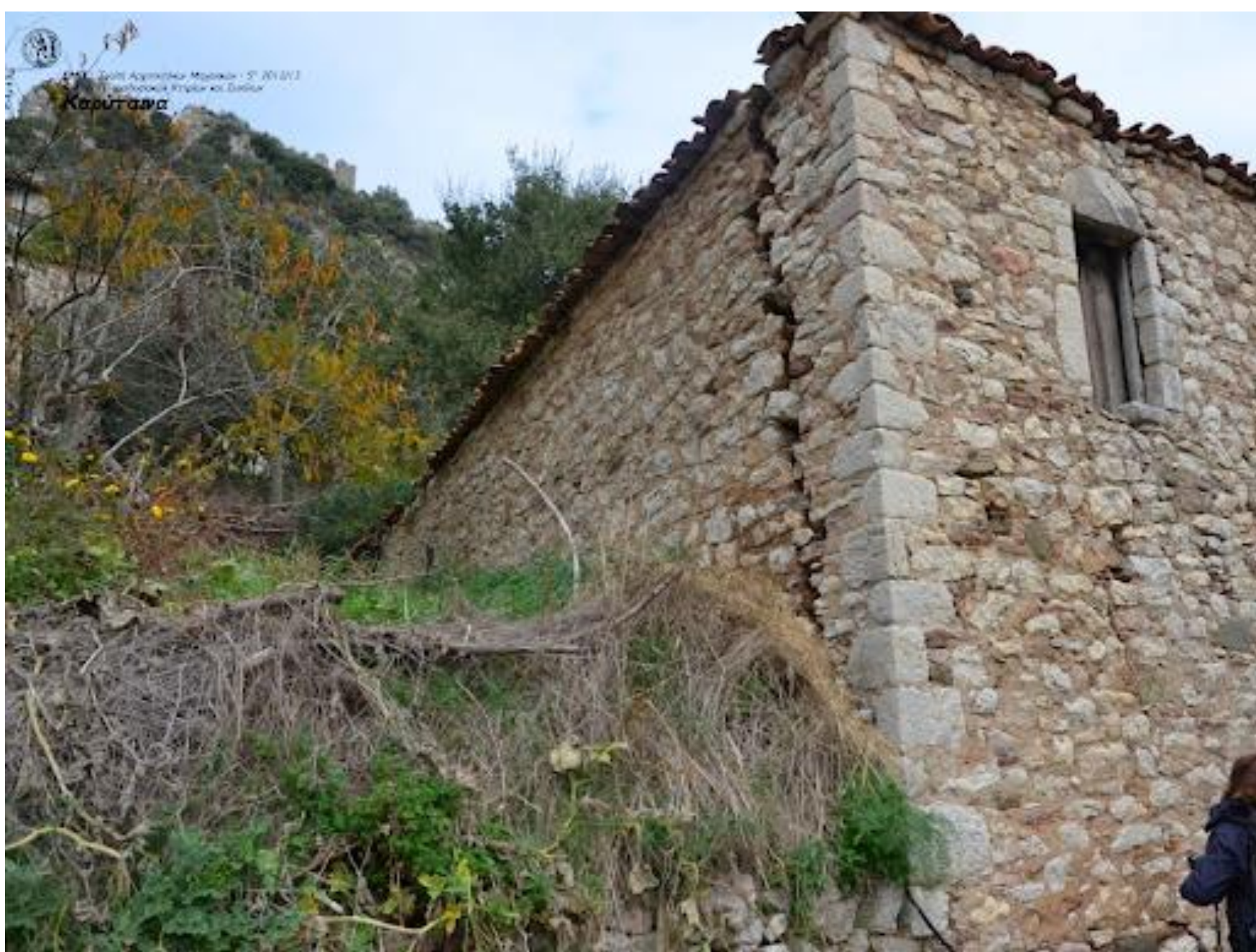
Ρωγμή οφειλόμενη σε καθίζηση
