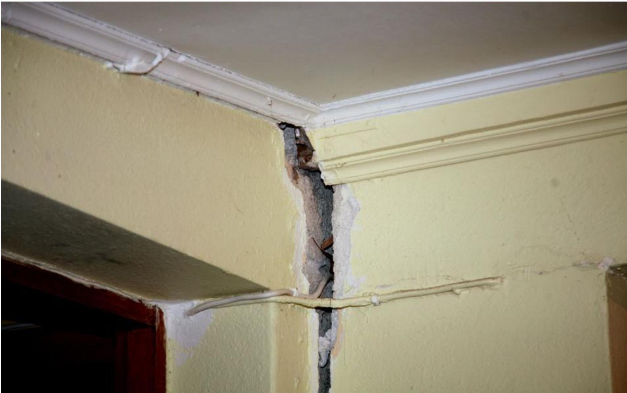
Ρωγμή οφειλόμενη σε καθίζηση
