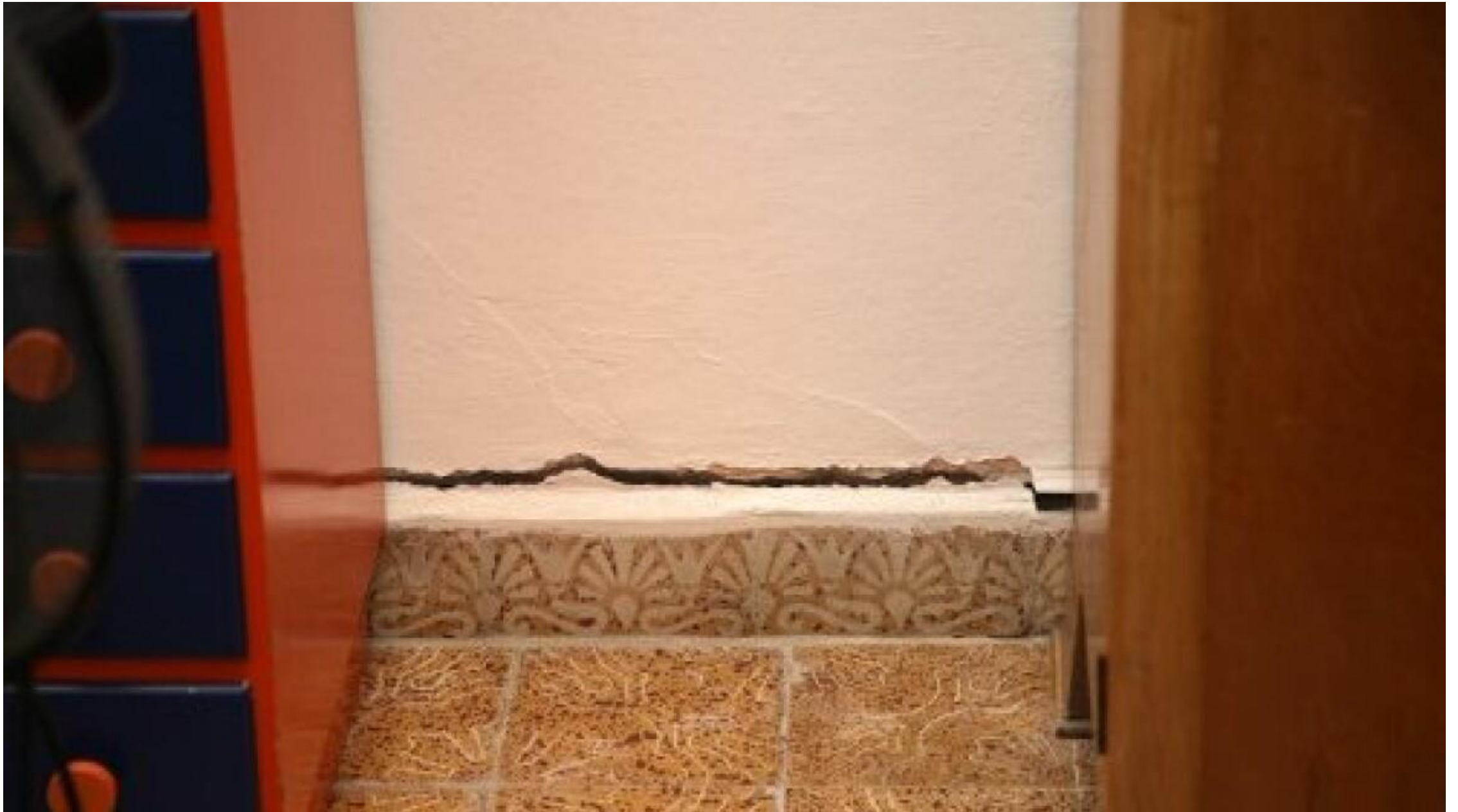
Ρωγμή οφειλόμενη σε καθίζηση
