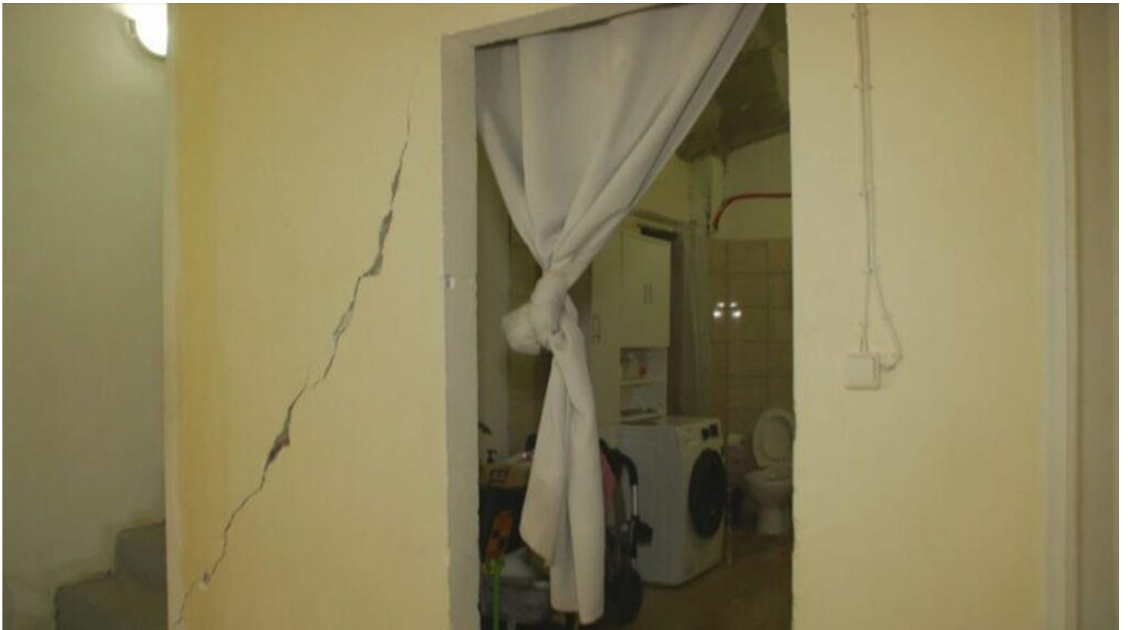
Ρωγμή οφειλόμενη σε καθίζηση (συγκλίνει προς το κέντρο της καθίζησης)
