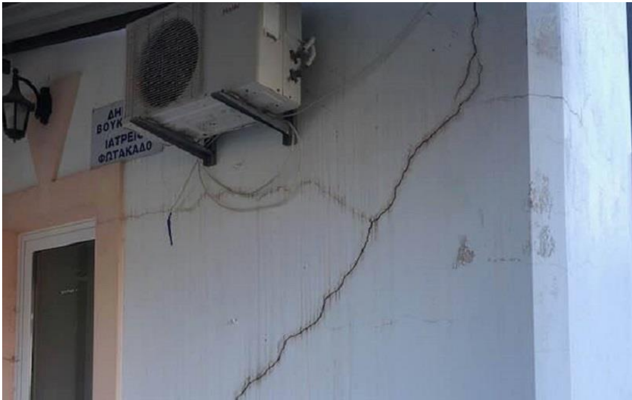
Ρωγμή οφειλόμενη σε καθίζηση (συγκλίνει προς το κέντρο της καθίζησης)
