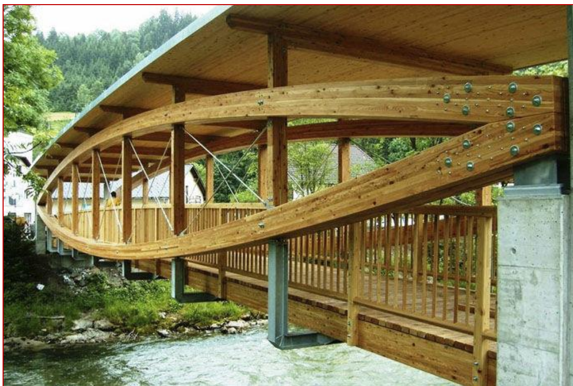
Εικ. 1. Ξύλινη πεζογέφυρα από καινοτομικό υλικό ξύλου, συνδυασμένη με σκέπαστρο για προστασία όλης της κατασκευής από τον καιρό και την υγρασία
