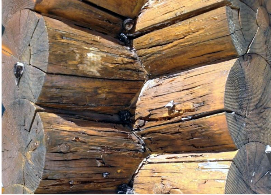
EIKONA 4. Προσβολή σηπτικών μυκήτων ( dry rot ) σε κορμοκατοικία.
