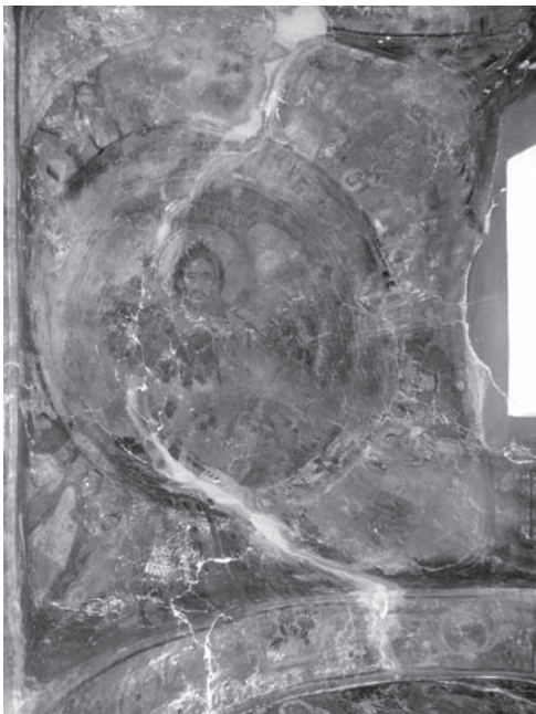
Εικ. 4α. Τμήμα θόλου νότιου κλίτους με θέμα τον Αγ. Ιωάννη τον Πρόδρομο, στον οποίο παρατηρείται εκτεταμένη ρωγμή η οποία έχει πληρωθεί με τσιμεντοκονίαμα. Επί-
