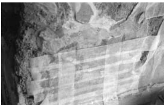
Εικ. 3. Λεπτομέρεια τοίχου 3, στάδιο συντήρησης, «οπλισμός» της επιφάνειας με γάζες και υδατοδιαλυτή κόλλα.
